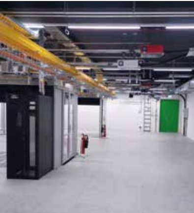
Blick in die Data Hall.
