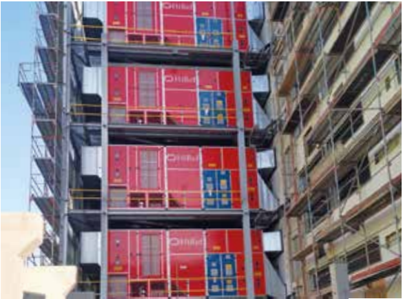
Main DC – Klima- und Freikühlanlagen seitlich zum Gebäude.
