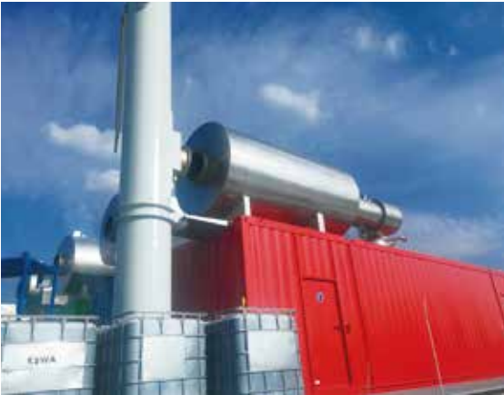
Main DC – Netzersatzanlage auf dem Dach.
