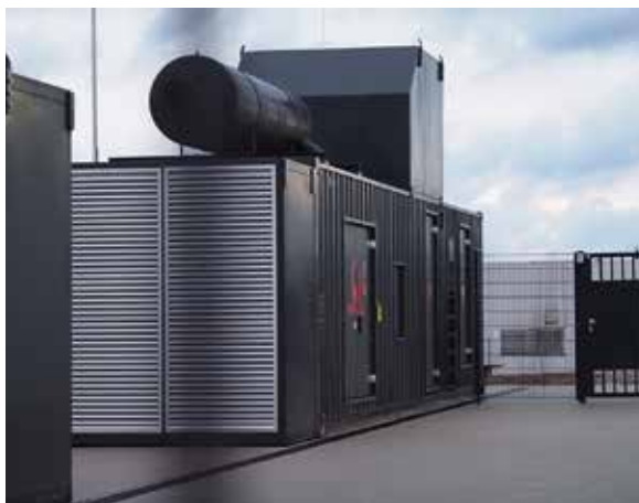
Netzersatzanlage im Außenbereich.
