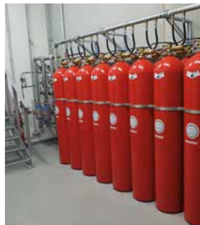
Feuerschutz durch moderne Löschtechnik.
