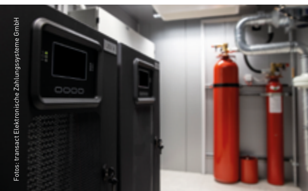
Eine NOVEC 1230 Feuerlöschanlage mit Brandmeldeanlage ergänzt das umfassende Sicherheitskonzept.
