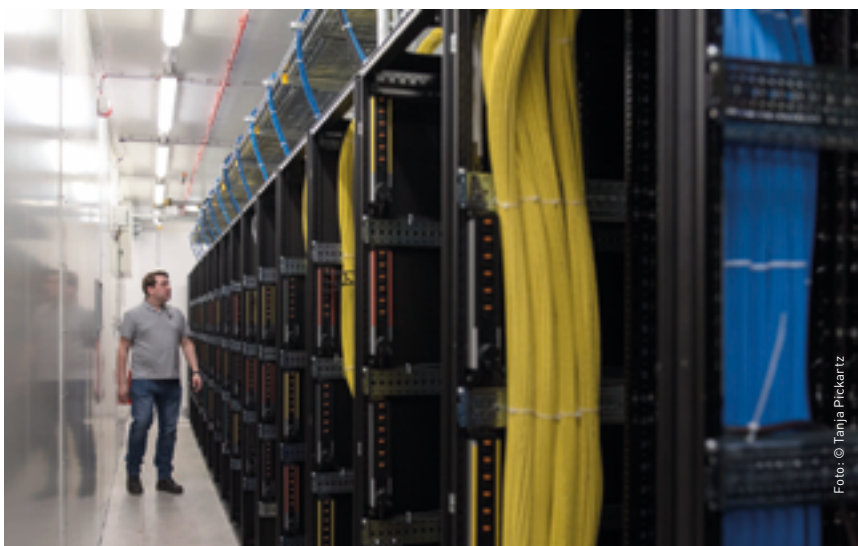
Patrick Komfort bei der Überprüfung der Rack-Verkabelung.
