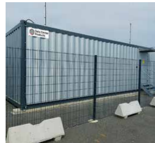
Das Container-Rechenzentrum bietet höchste Verfügbarkeit und sichersten Schutz für die sensiblen Produktionsdaten.
