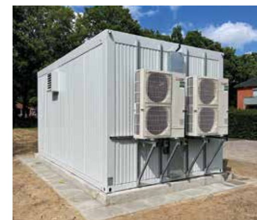
Ausweichrechenzentrum in einem Container.
