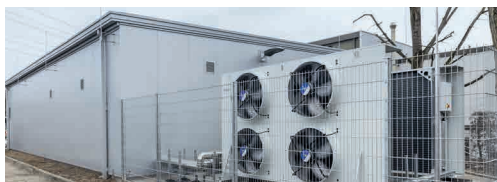
Stadtwerke Karlsruhe Outdoor-Rechenzentrum
