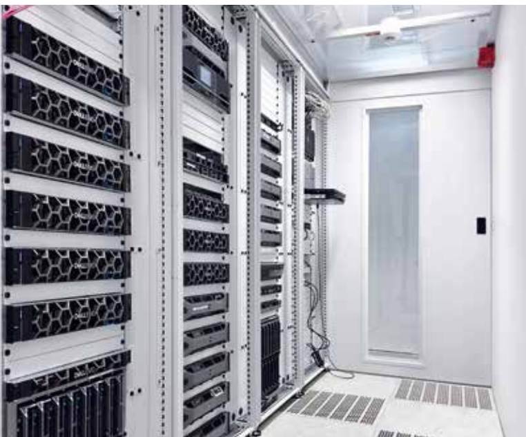
Kalt-/Wärmegangeinhausung zur optimalen und energieeffizienten Luftführung.
