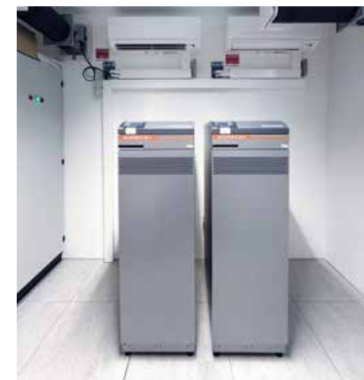
USV-Anlagen sorgen für eine ständige, unterbrechungsfreie Stromversorgung.
