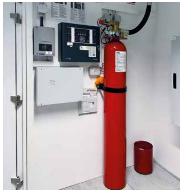
Brandfrüherkennungssystem inkl. NOVEC 1230 Feuerlöschanlage mit Brandmeldeanlage.
