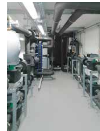
Kältezentrale des Rechenzentrums im Zwischengeschoss.
